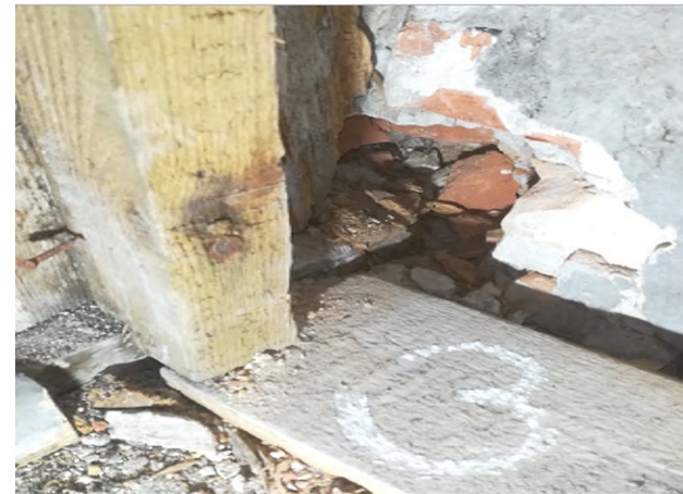
Braunfäule an Deckenbalkenkopf
