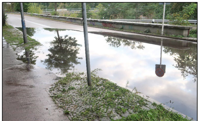
Abbildung 57: Nach einem Starkregen überflutete Straße. © M. Olonscheck.
