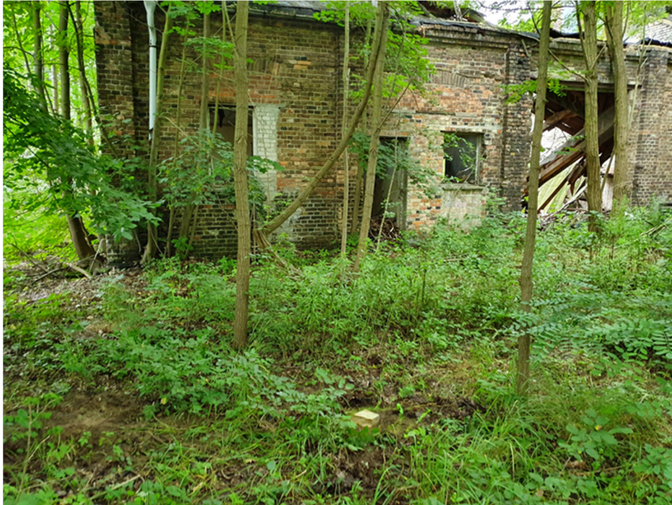
Foto Nr. 3: Eingestürztes Haus neben dem Schornstein
