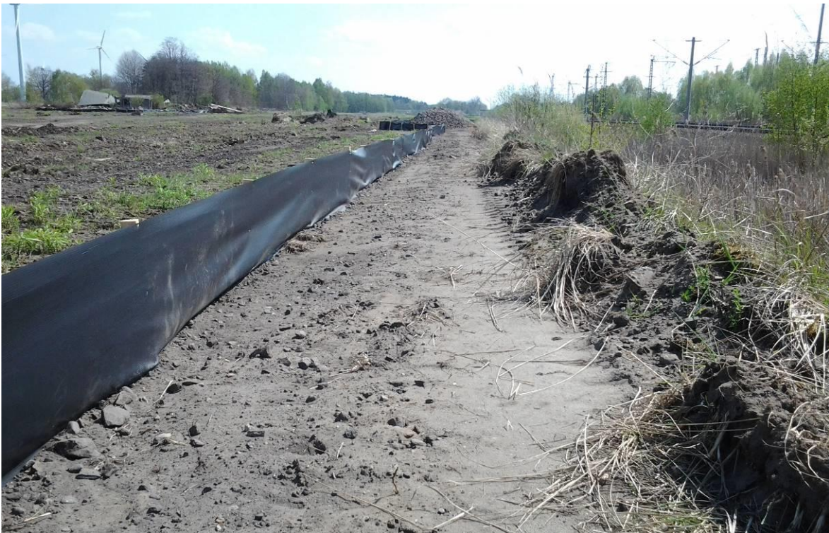
Abbildung 3-3: Beräumter Korridor für den Kleintierzaun-Bau in einem PVA-Projekt an der ICE-Trasse Berlin - Hamburg bei Neustadt Dosse (LEGUAN GMBH 2013a)
