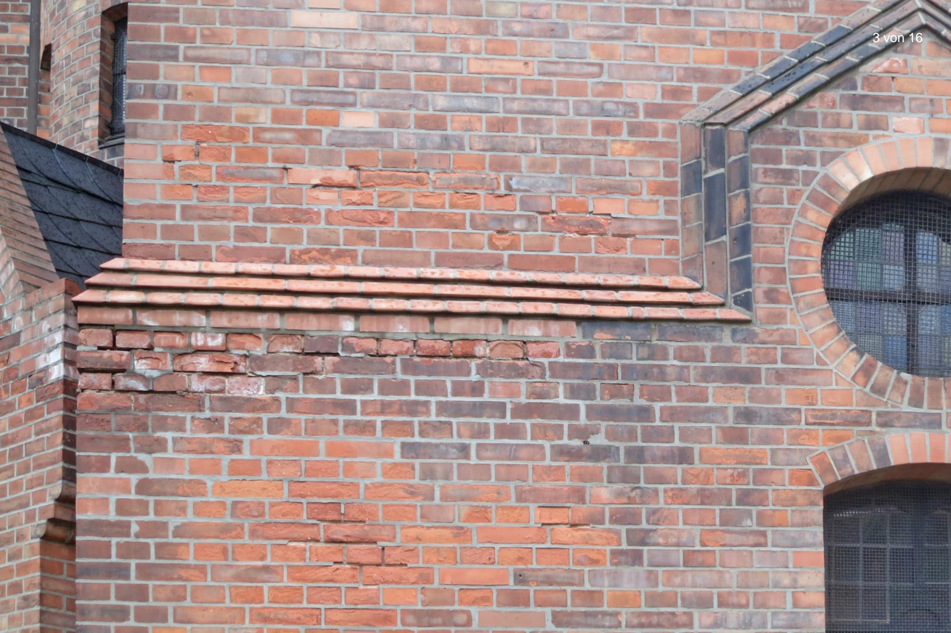
Schäden im Ziegelmauerwerk
