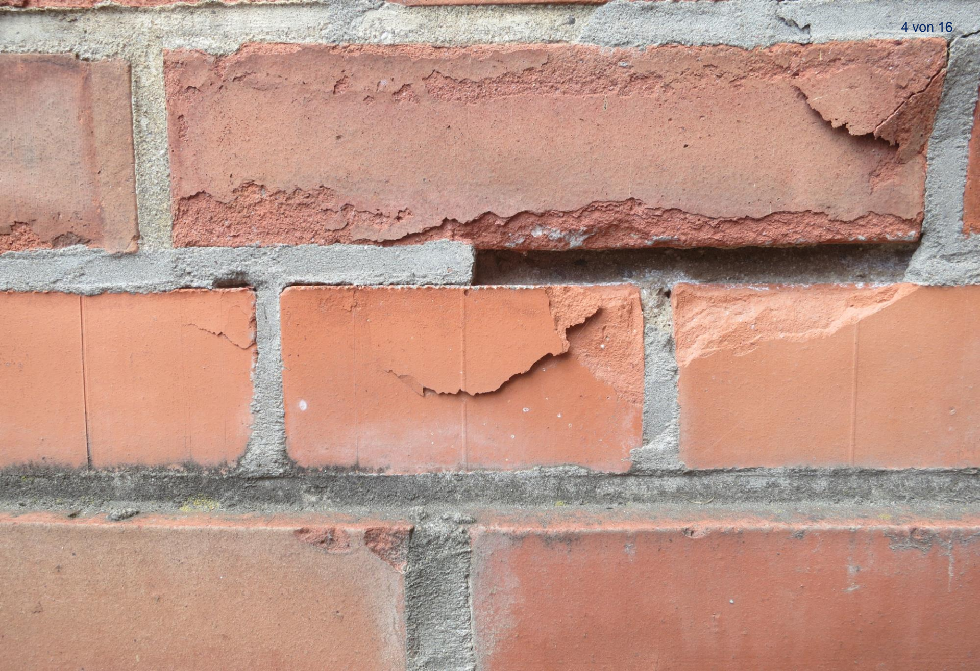
Frostspaltungen und Abplatzungen
