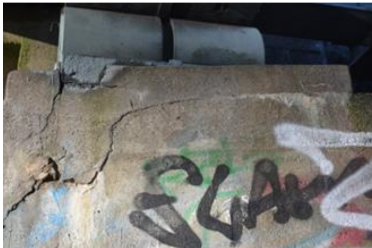
Schaden Schrägriss Sockel Lager
