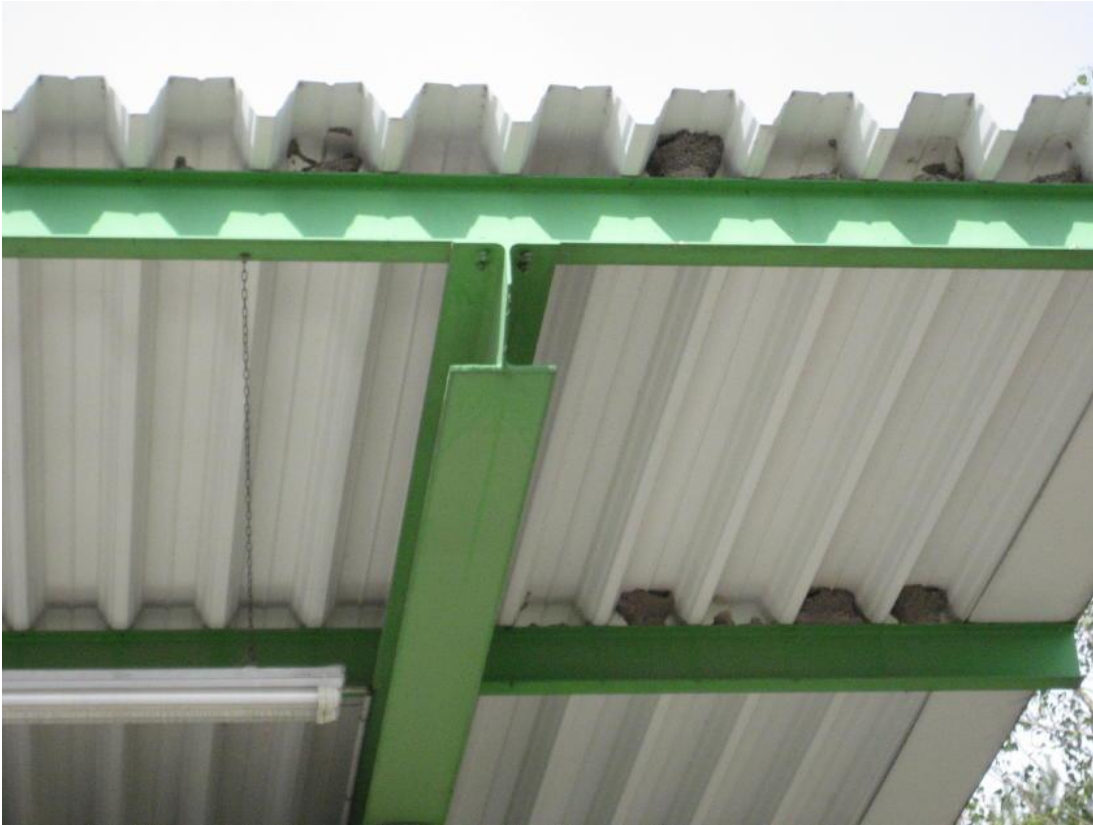
Abb.3 : Mehlschwalbennester unter dem Dach am Eingang der Deponie, 26.06.14
