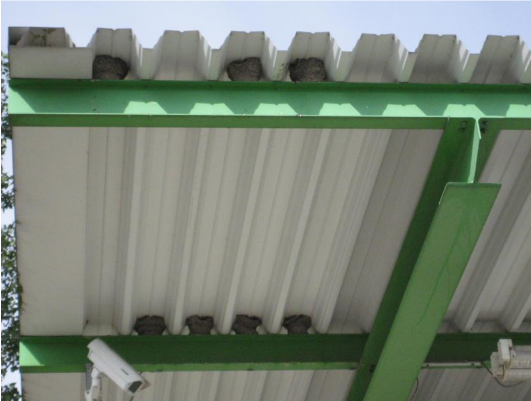
Abb. 2: Mehlschwalbennester unter dem Dach am Eingang der Deponie, 26.06.14
