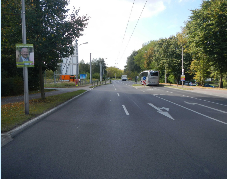
Bild 1: Beginn der Baustrecke mit Aufweitung des Fahrbahnquerschnitts von 2 auf 3 Fahrspuren; Blickrichtung: Westen
