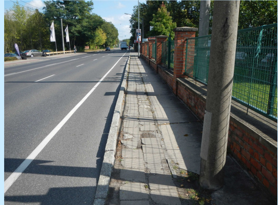
Bild 4: Behelfsgehweg mit stark reduzierten Querschnitt und Beleuchtungsmast im Gehwegquerschnitt; Blickrichtung: Osten
