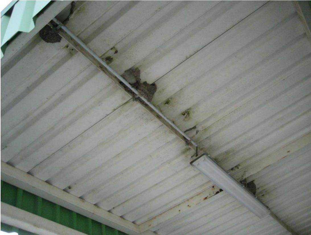
Abb. 5: Mehlschwalbennester unter dem Dach eines weiteren Gebäudes der Deponie, 26.06.14
