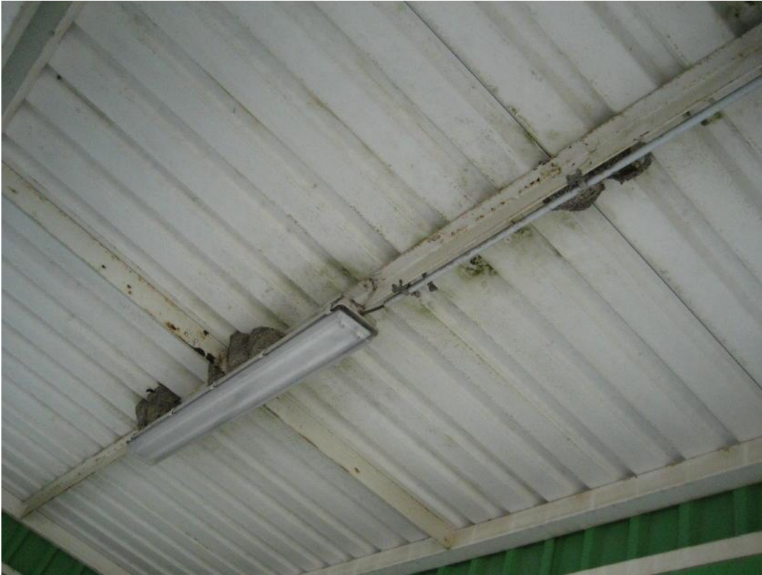
Abb. 4: Mehlschwalbennester unter dem Dach eines weiteren Gebäudes der Deponie, 26.06.14
