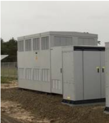
Abbildung 11 Beispiel einer Übergabestation/Trafo
