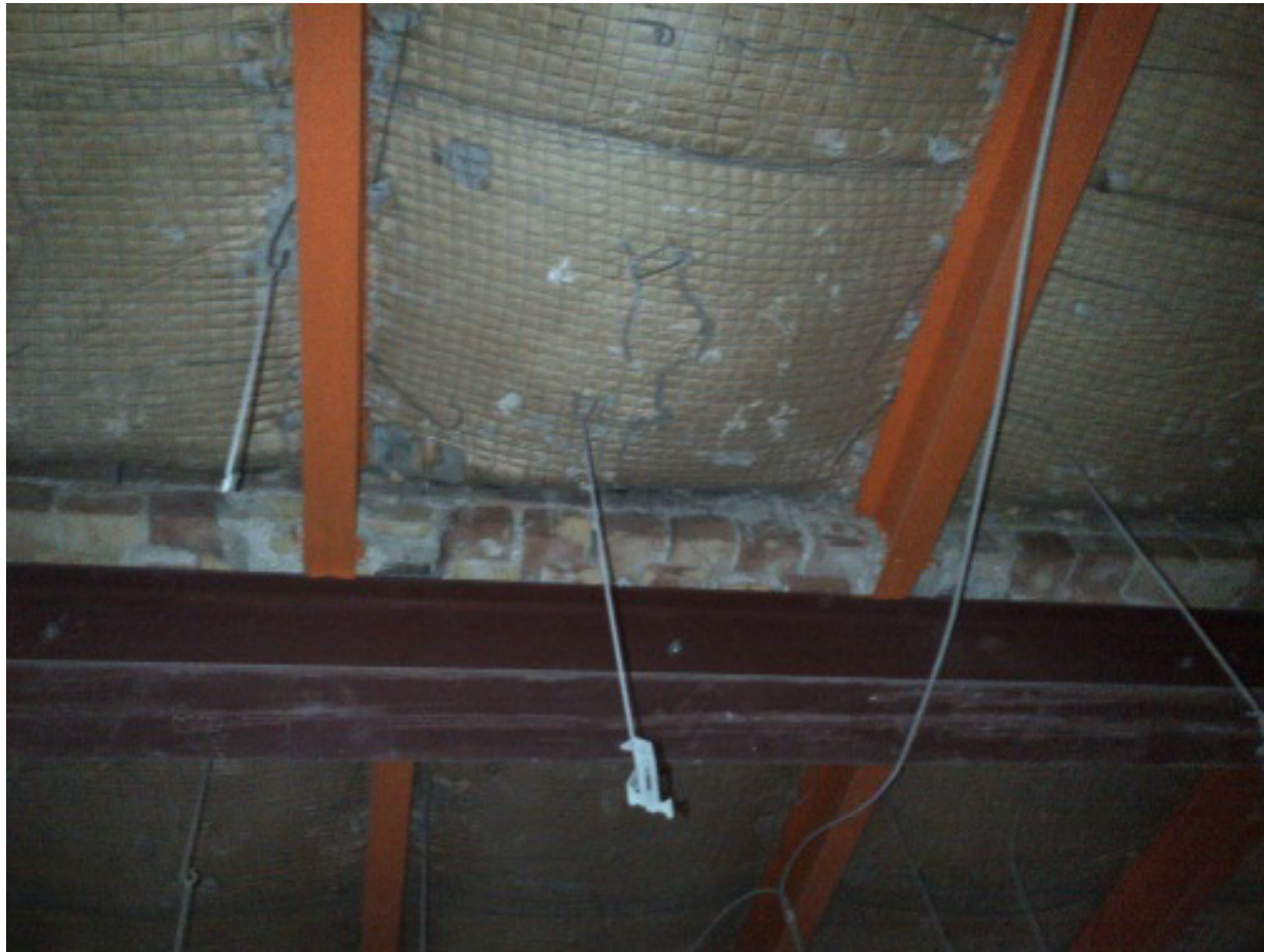
Weitgehend intakte Terrastdecke von unten (Raum rechts neben der Durchfahrt)
