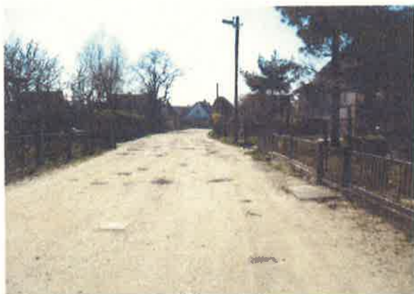
Abb. 1: Gutenbergstraße - vor der Straßenbaumaßnahme
