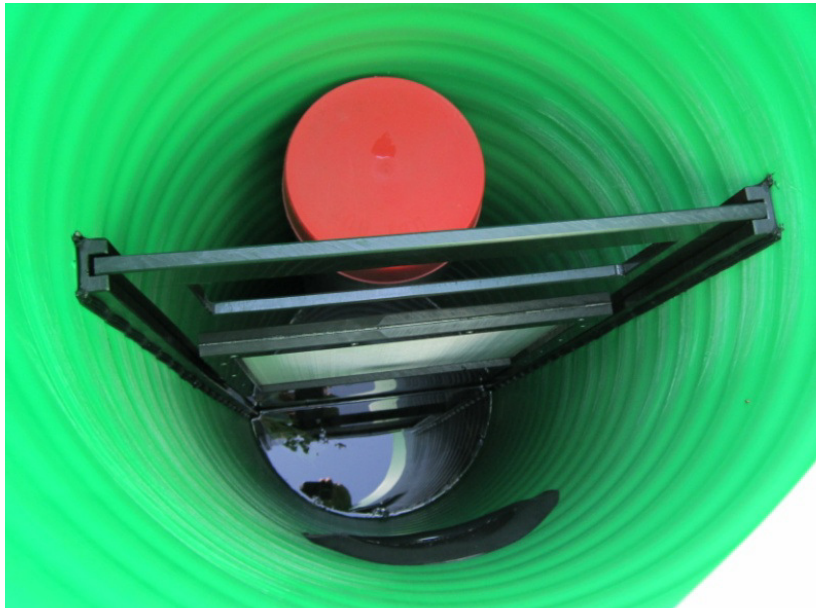
Abb 15 und 16: Reinigungsschacht einer Rigolenentwässerung
