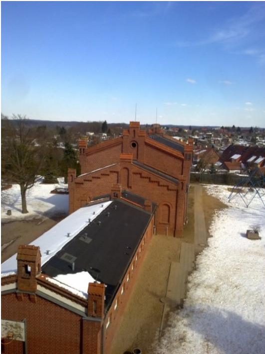
Möglicher Aufstellort PV-Anlage
