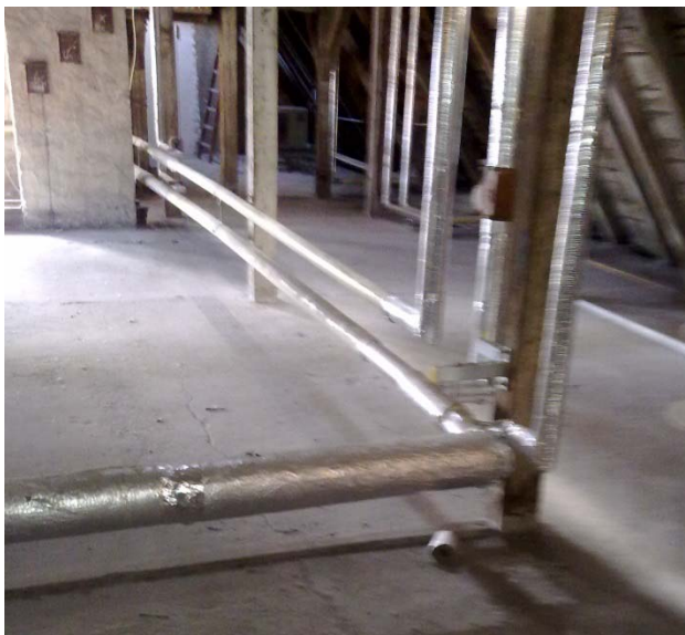
Heizleitungen über der obersten Geschossdecke
