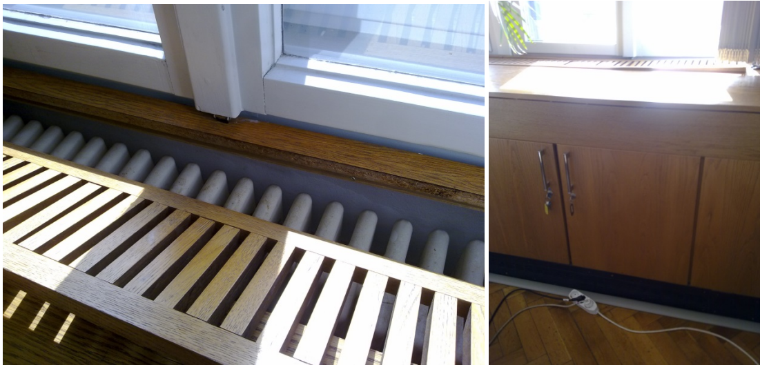
Eingebaute Heizkörper Büro 217
