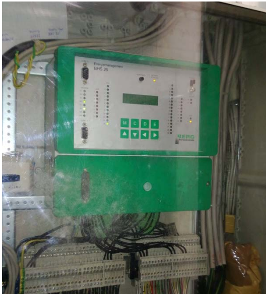
Lastregelung zur Reduzierung der elektrischen Hausanschlussleistung
