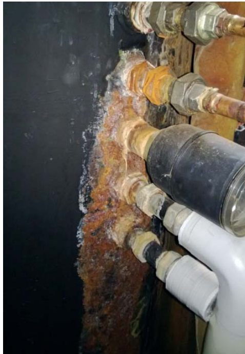
Roststellen am Speicher
