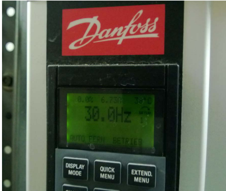
Frequenzumrichter für Beckenwasserpumpen im reduz. Betrieb
