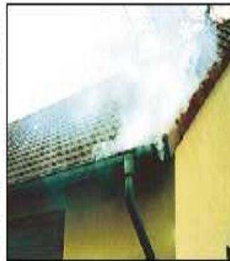
Der Nebel bringt es an den Tag: Es besteht eine Verbindung zwischen Schmutzwasserkanal und Regenwasserabfuhr.
