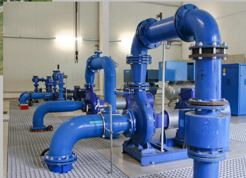
Wasserwerk Finow - Blick in Pumpenhalle -
