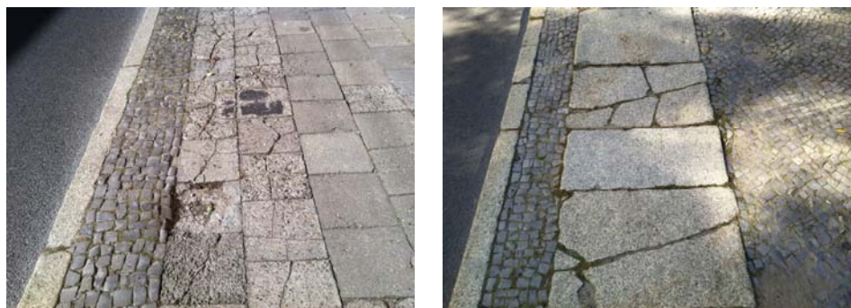
Abb. 14: Oberflächenschäden im Gehweg
