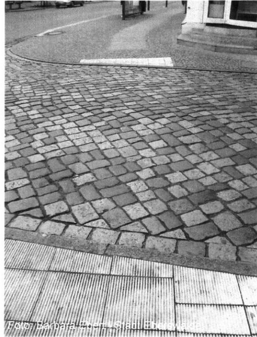
☹ Querungsstelle mit diagonal und breitfugig verlegtem Pflaster
