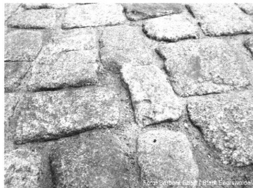
☹ Straße mit mehreren behindertengerechten Stellplätzen, ohne Bordsteinabsenkungen, Oberflächenbeschaffenheit
