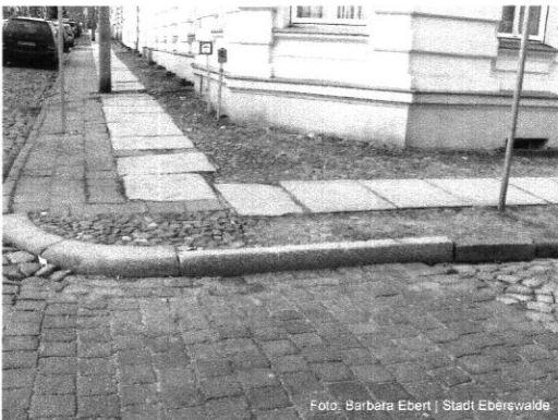
☹ Desolater Fußweg, ohne Bordsteinabsenkung an Querungsstellen
