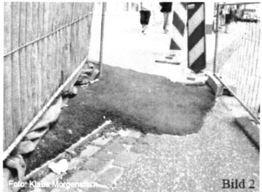
☹ Ungeeignete „Baustellensicherung“ im Gehwegbereich, Unfallgefahr
