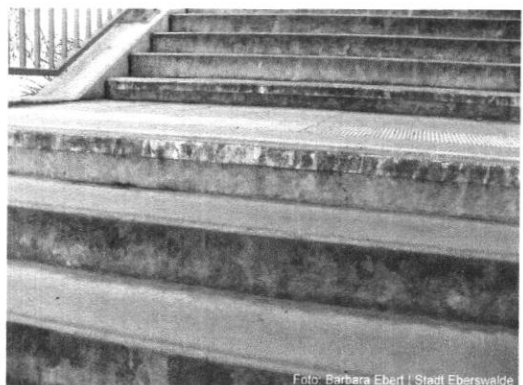
☹ Stufenmarkierung nicht mehr erkennbar
