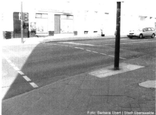
☹ Fehlerhaft angelegte Bodenindikatoren und angebrachte Bedienelemente
