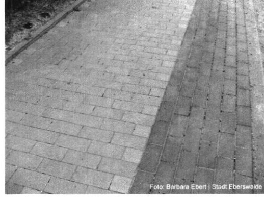
☹ Fehlender taktiler Kontrast zwischen Gehbahn und Sicher- heitsstreifen
