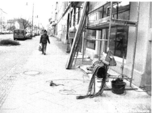
☹ Ungesicherte Baustelle im Gehwegbereich
