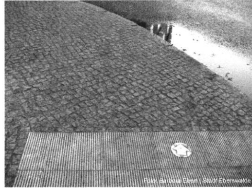
☹ Zu großer Einmündungsradius, Querungsstelle zu lang, fehlerhaft angelegte Bodenindikatoren
